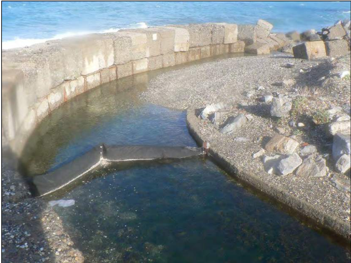
Figura 21: Canale di scarico della centrale Enel (Foto 21)
