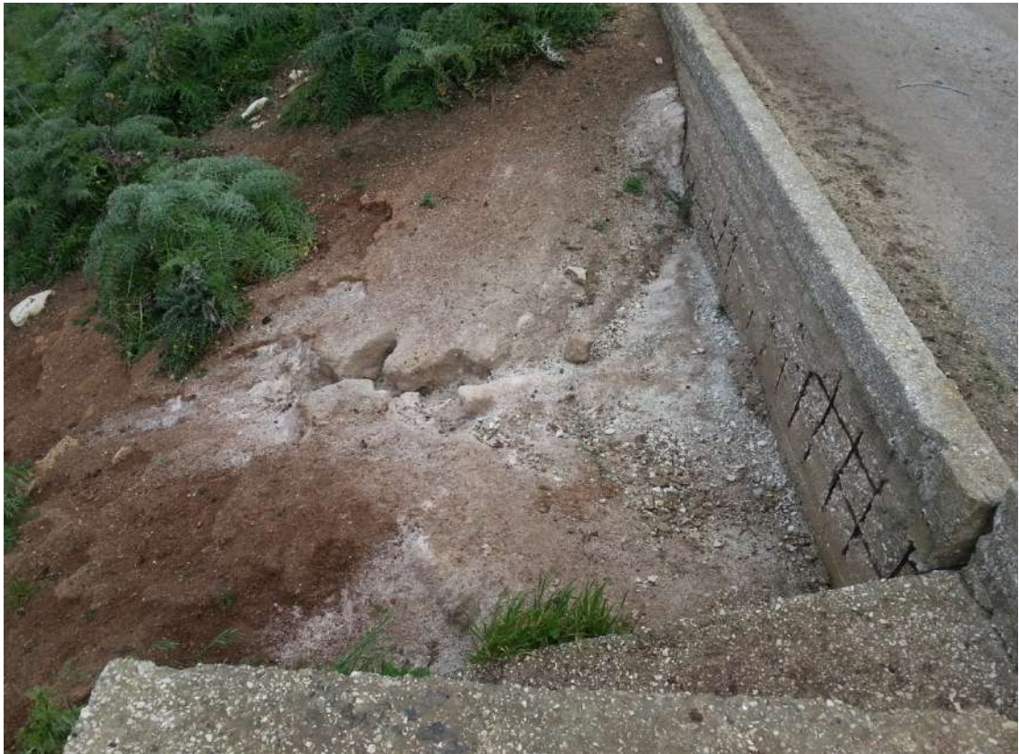
Foto 11 – Paramento di valle - Particolare area decorticata
