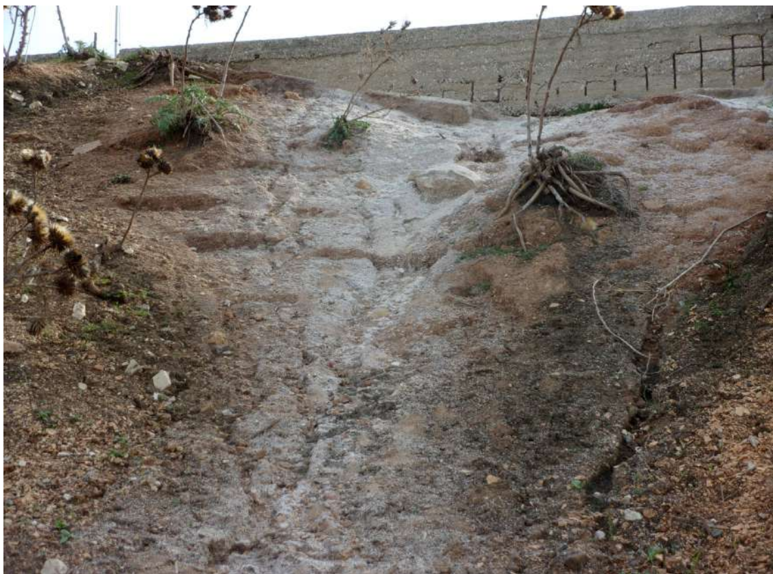
Foto 12 – Paramento di valle - Particolare area decorticata
