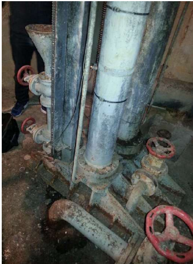
Foto 4 – Particolare gruppo paratoie scarico di fondo
