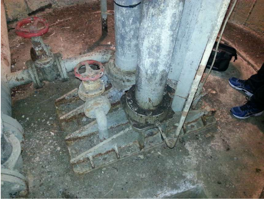
Foto 3 – Particolare gruppo paratoie scarico di fondo
