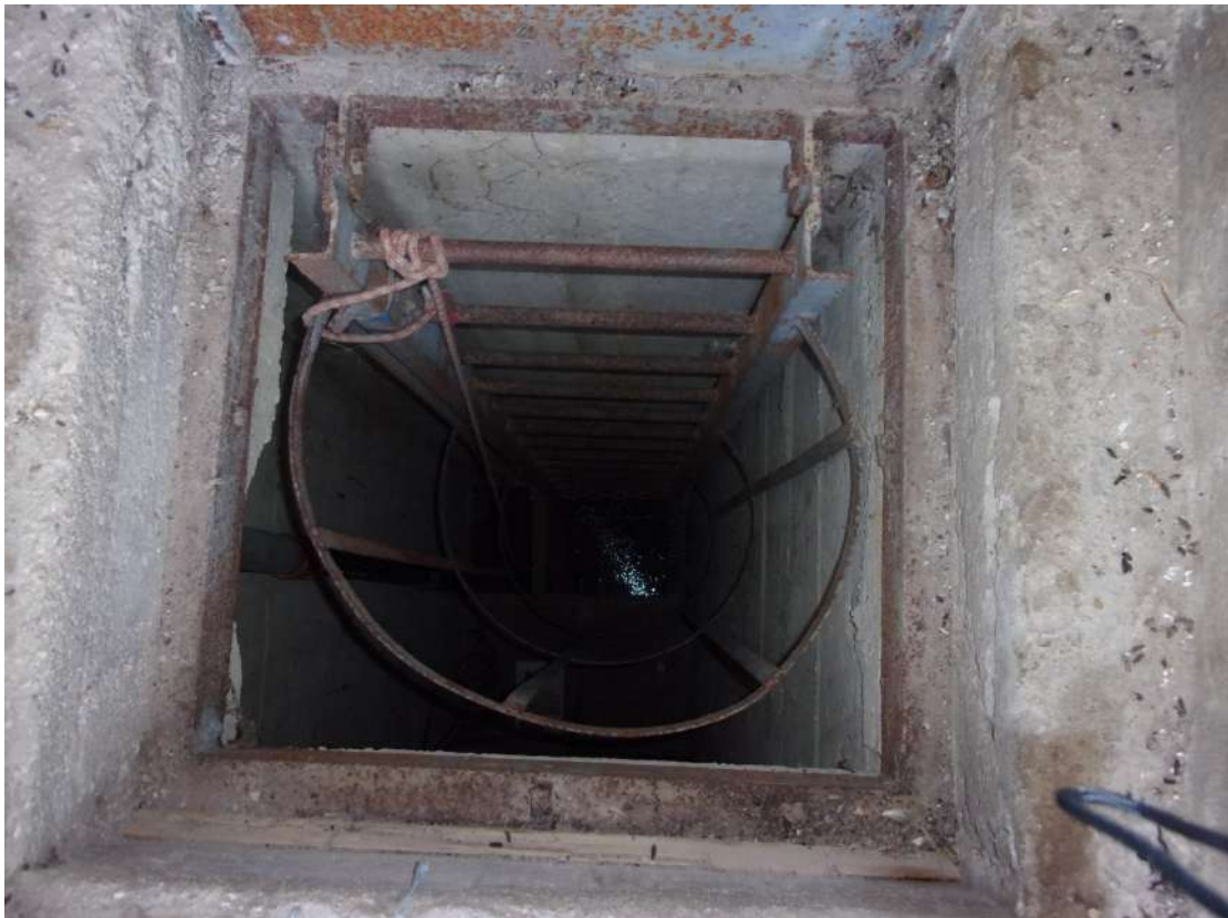
Foto 18 – Accesso al pozzo raccolta perdite drenaggi
