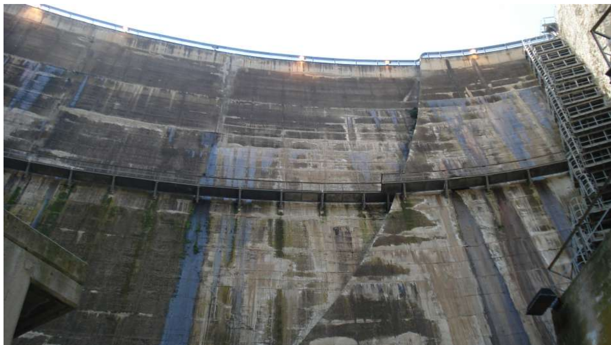
FOTO 9 - Venute sul paramento di valle in DX - coronamento e passerella a quota 146,00
