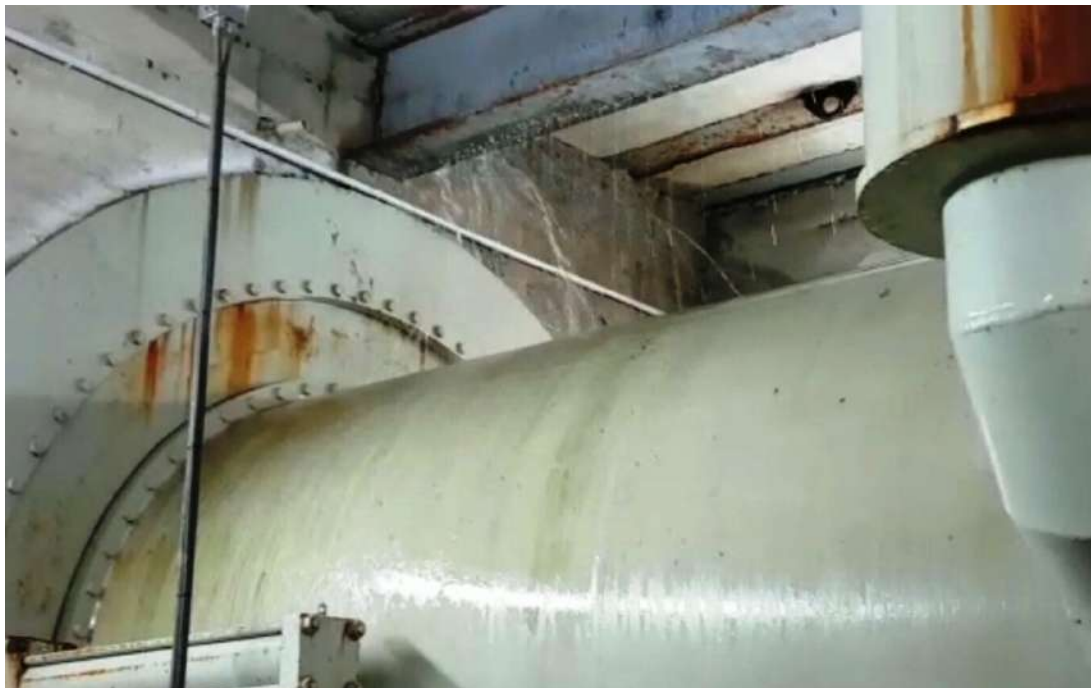
FOTO 15 - Filtrazioni d'acqua dal solaio della camera di manovra degli scarichi sussidiari
