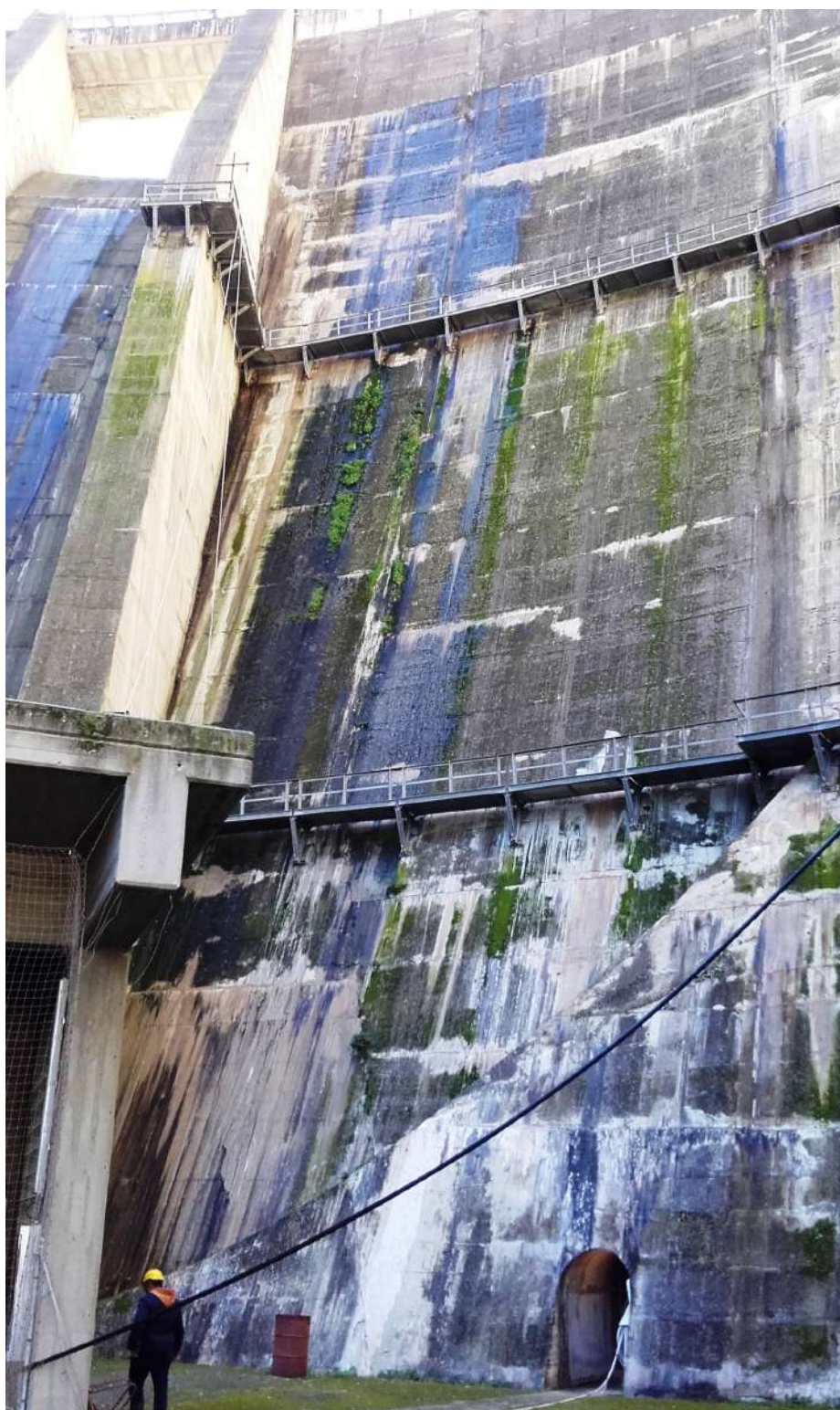
FOTO 11 – Venute sul paramento di valle tra sponda in DX e scivoli scarico di superficie, dal coronamento e fino a piazzale a quota 110,00
