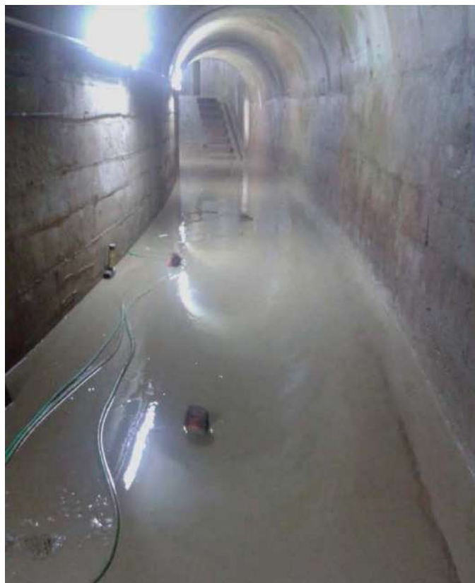
FOTO 7 – Cunicolo drenaggi in fondazione quota 93,00–vicino punto raccolta dreni perimetrale
