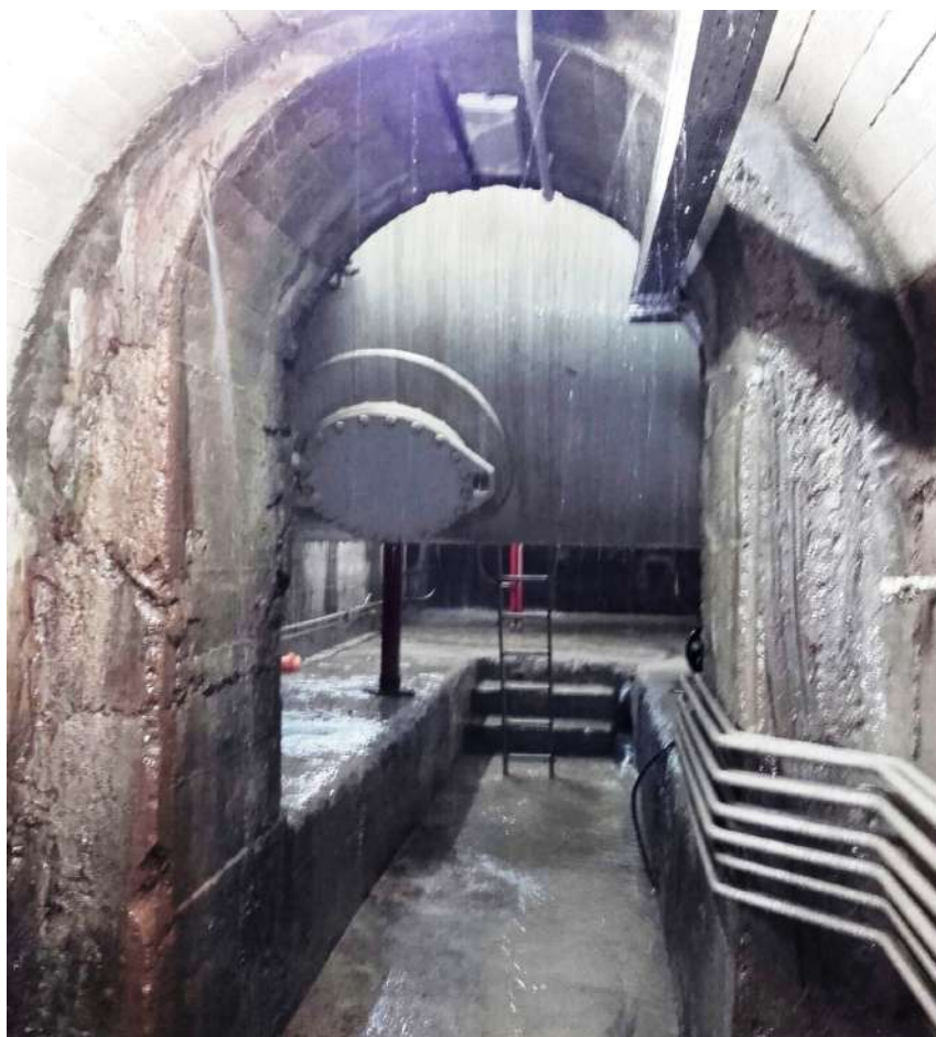
FOTO 16 - Filtrazioni d'acqua dal solaio della camera di manovra degli scarichi sussidiari
