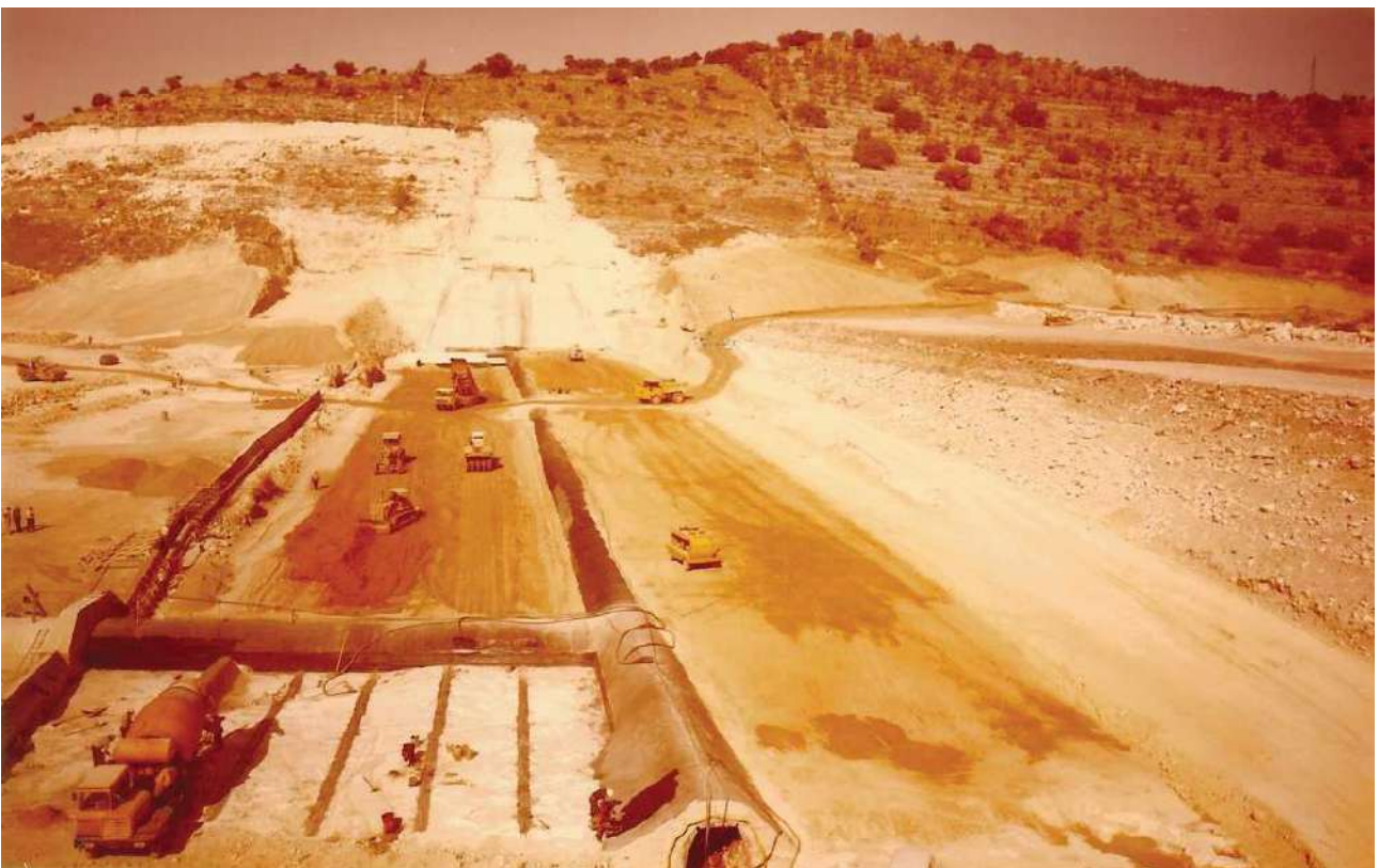
Cunicolo alla base del nucleo dello sbarramento e cunicolo trasversale di collegamento
