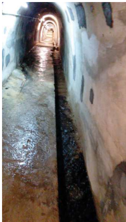
Cunicolo raccolta acque di drenaggio alla base dell'imposta del paramento di valle
