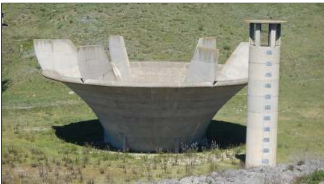
Figura 3-6: Sfiatore a calice sinistro con torrino aeroforo
