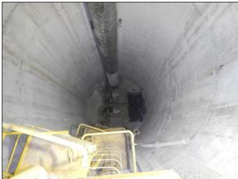
Figura 3-10: Torre di manovra – Interno della torre, con le scale alla marinara, il tubo aeroforo e le due saracinesche
