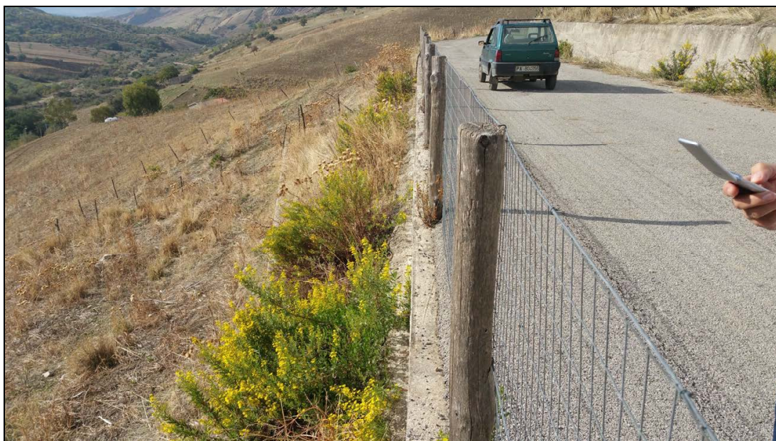
Foto n. 2 – dissesto 072-6PE-128 (Particolare della strada a monte della frazione al margine della quale è stata realizzata la palificata)
