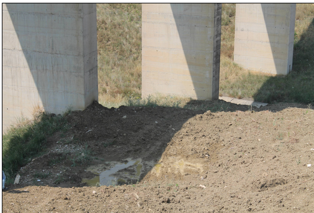
Foto n. 1 – dissesto 044-9AL-032 (viadotto Scio)
