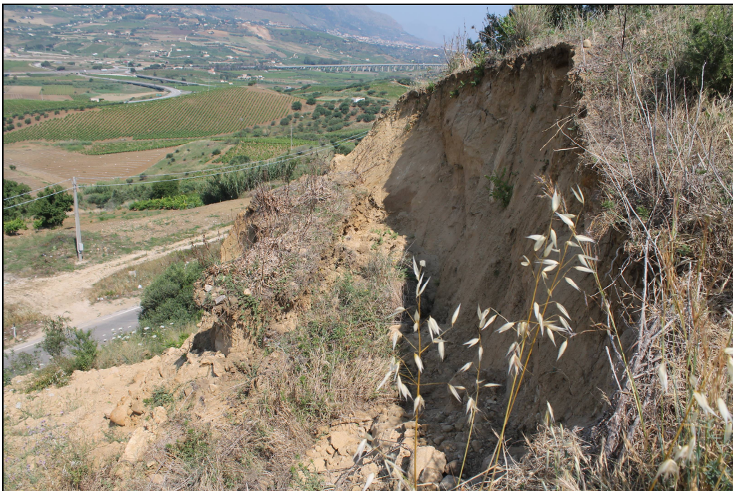
Foto n. 3 – dissesto 045-9AL-021 (S.S. n. 113 Km 332+700)
